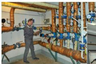
контроль работы теплового пункта
